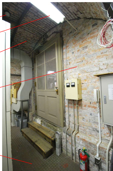
変電室(A)内部 1
